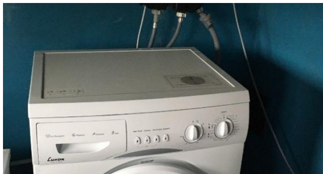
Waschmaschinenanschluß im Keller
