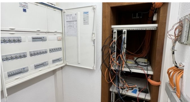
Abstellraum 2 / Elektrorum / Serverraum
